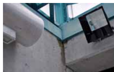
Desperfectos en la cubierta de la piscina
